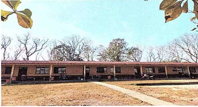
Foto 1. Módulo 1. Parte frontal, laminas oxidadas.
